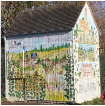
Transformatuer SICAE de Grisy 04, rue de GI De Gaulle 95810 Grisy-les-Plâtres
